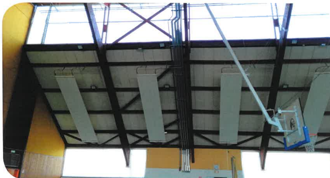
Gymnase de Courtenay - Panneaux rayonnants, raccordés à la chaufferie bois
